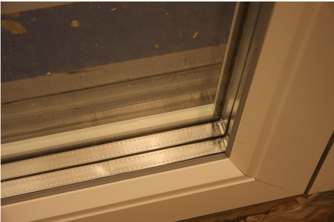
Bild 8 – Fönstrets ena nedre hörn från utsidan.
